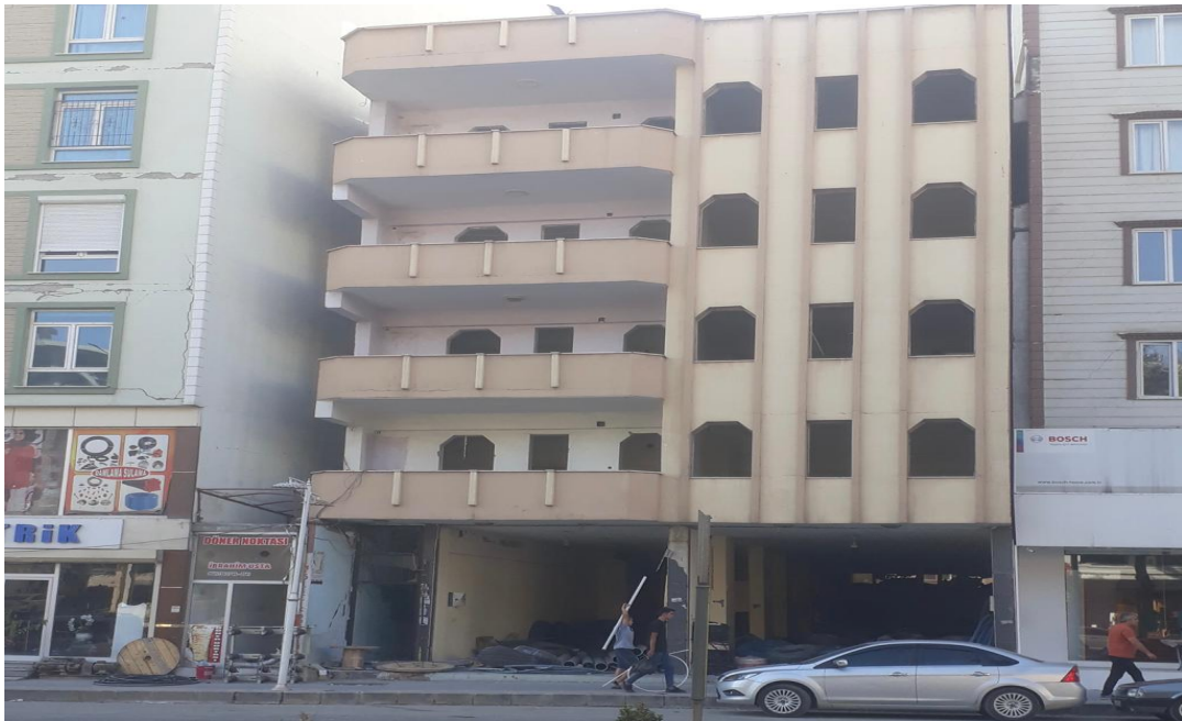
Foto 5: Pazarcık kent merkezinde yıkım bekleyen hasarlı bina-10.08.2023
